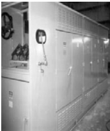
تصویر ۷-۷: بانک خازنی داخل تابلو با فیلتر
