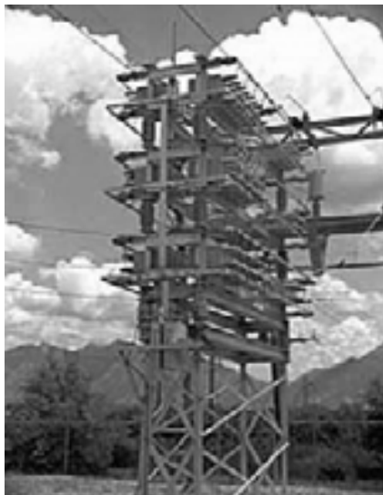
تصویر ۶-۷: بانک خازنی درون پست
