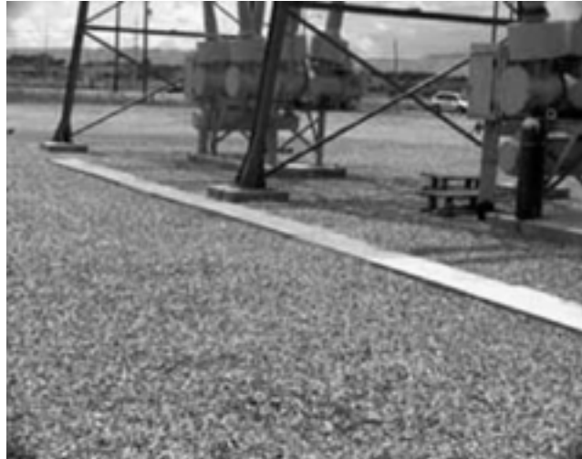
تصویر ۲۳-۱۶: کانال مخصوص کابل‌های کنترل در یک پست
