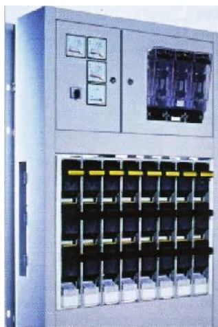
شکل ۱۴،۳- تابلوی توزیع با کلید فیوز عمودی
