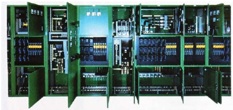
شکل ۱۴،۴- تابلوی توزیع فشار ضعیف با کلید فیوز ریلی
