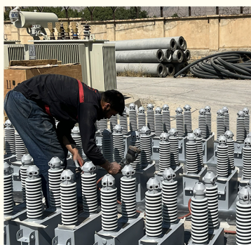
آماده سازی خازن‌های متعلق به شرکت توزیع نیروی برق همدان
